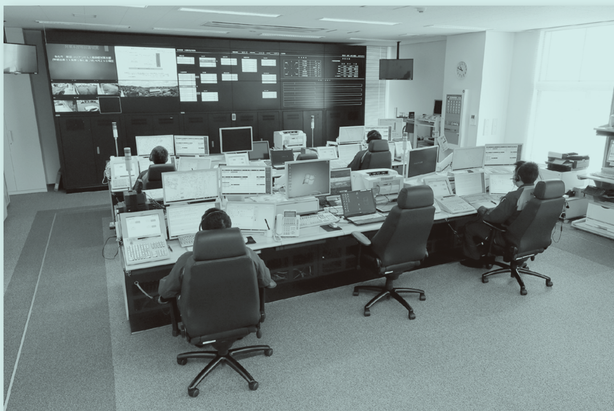
高機能消防指令センター
